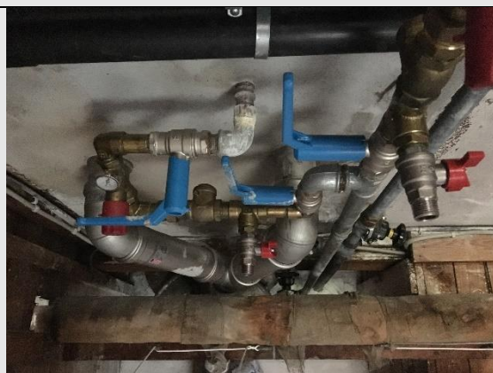
Afspærringsventiler i kælderplan
