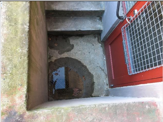
Tilstoppet afløb i kældernedgang mod gade.
