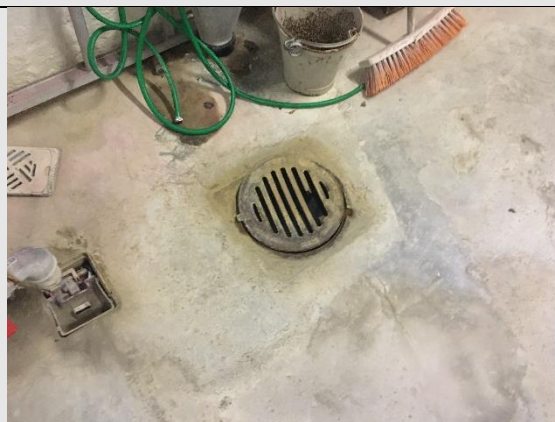
Afløb i kælder.
