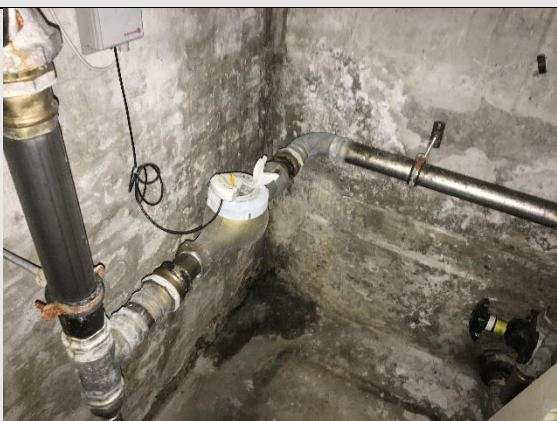
Vandmålerinstallation i kælderplan
