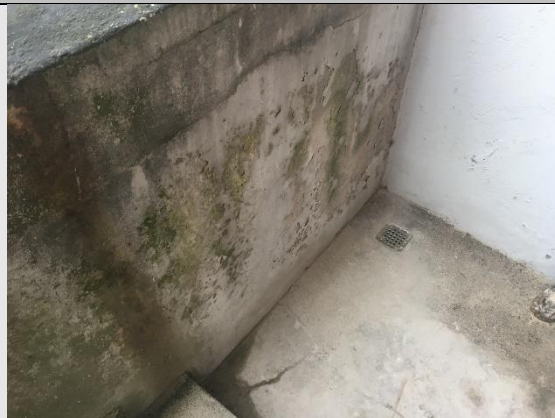
Afløb i kældernedgang.
