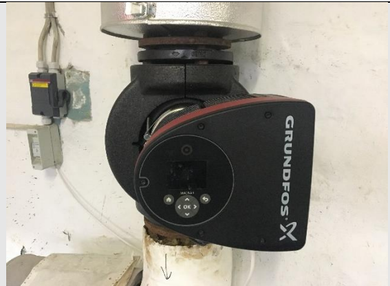
Cirkulationspumpe til centralvarme
