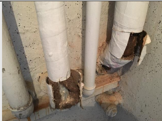
Isolering på vandinstallationer i kælderplan
