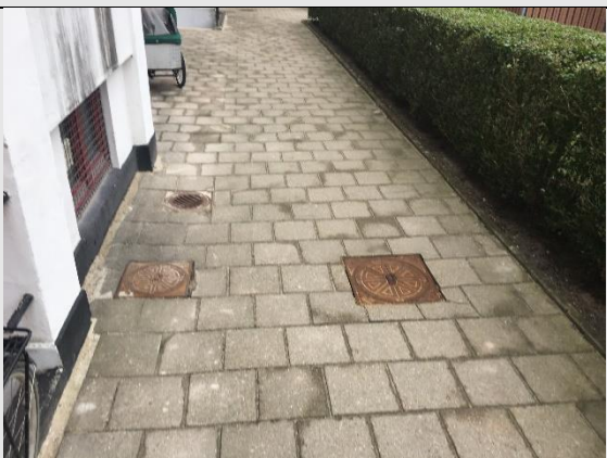
Afløb og kloak mod gård.
