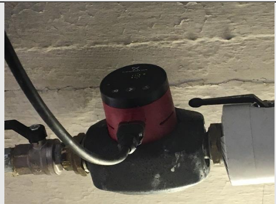
Cirkulationspumpe til varmt brugsvand
