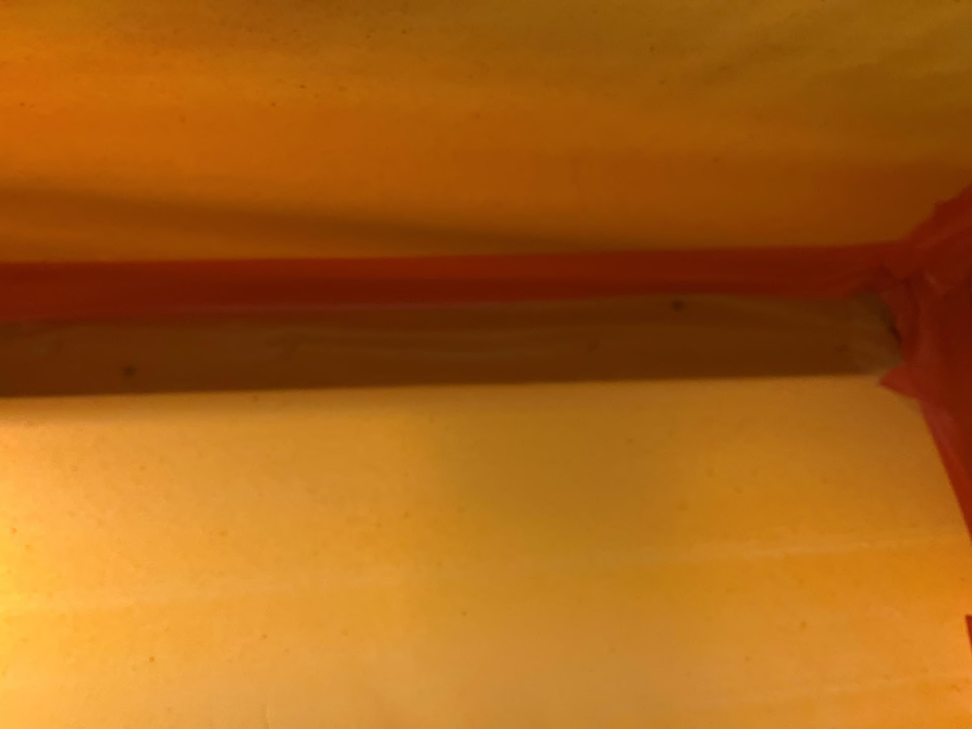
Foto 8: Eksempel på forsegling af sluser/afskærmninger indvendig.
