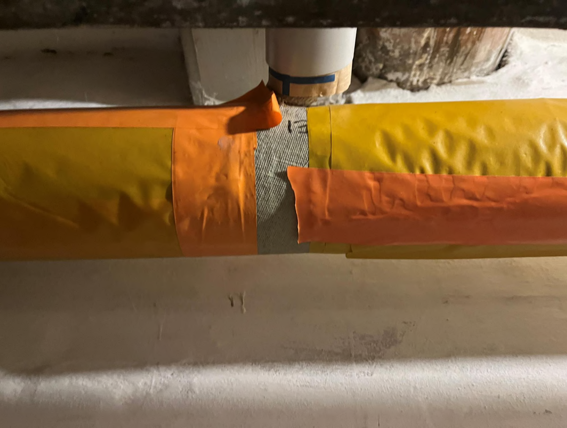
Foto 3: Skæresnit inden asbestholdig isolering er fjernet
