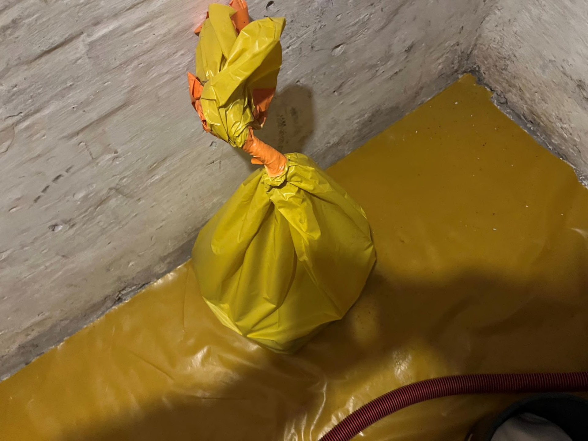
Foto 6: Forseglet pose med asbest affald.
