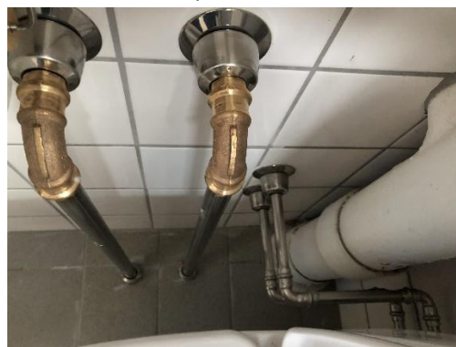
Gennemføringer af vandrør
