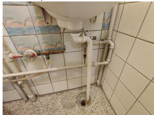
Vandrør på badeværelse med vandmåler
