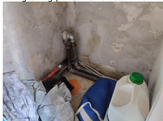
Ældre vandrør ført fra toilet
