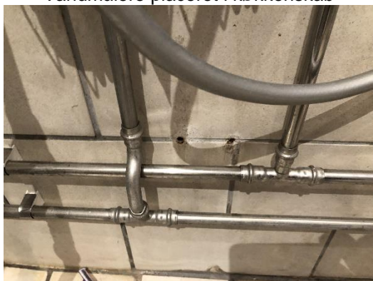
Vandrør på badeværelse
