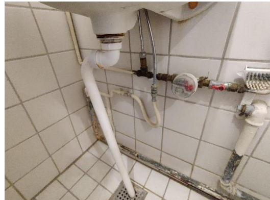
Vandrør på badeværelse med vandmåler
