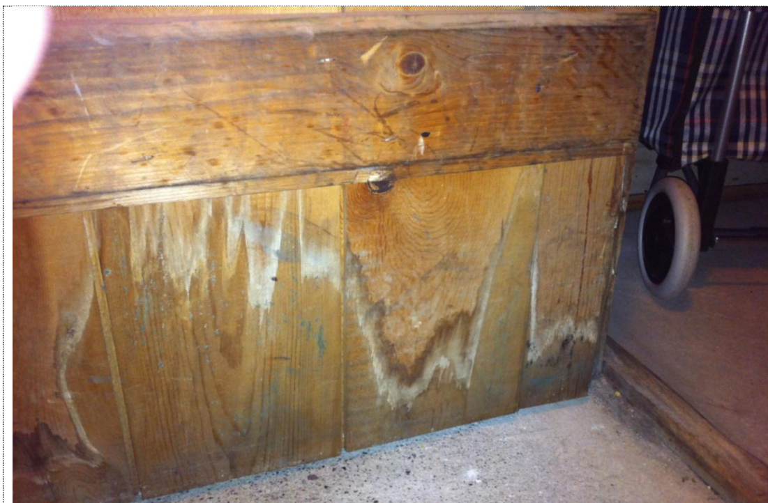
5. Fugtskade og skimmelvækst på træværk, Rubinsteinsvej
