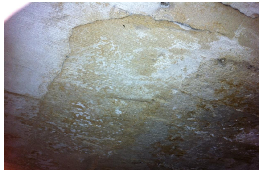
7. Loft i cykelkælder, Händelsvej. Gammel fugtskade
