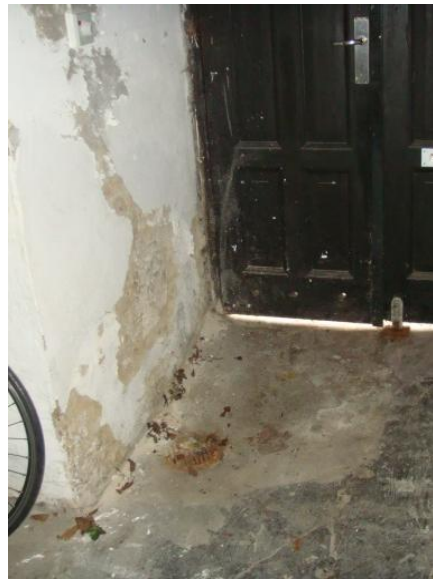
Afskallende puds i kældergennemgang
