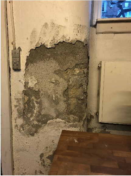
Fugtig ydervæg i kælder
