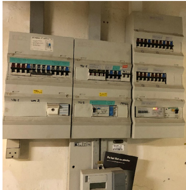
Relæ i kælder
