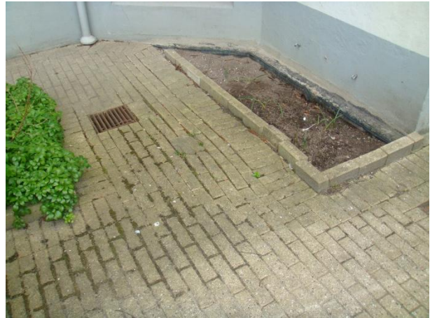
Sætninger af belægning på gårdside
