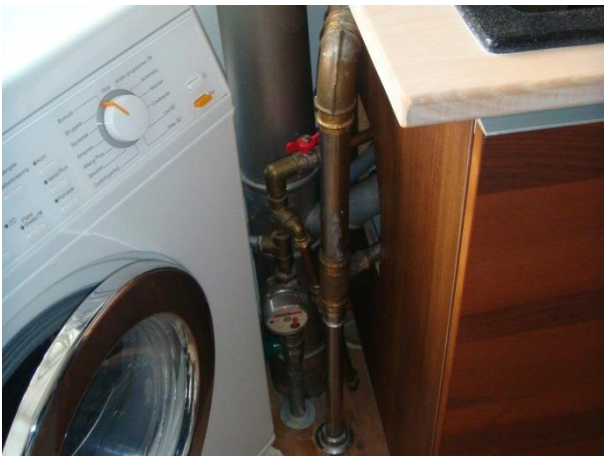
Blandede rør i vandinstallation
