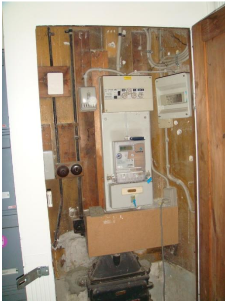
Forsyningstavle i opgang 18
