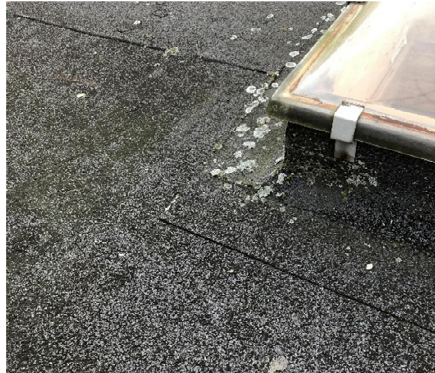
Inddækning ved lyskuppel
