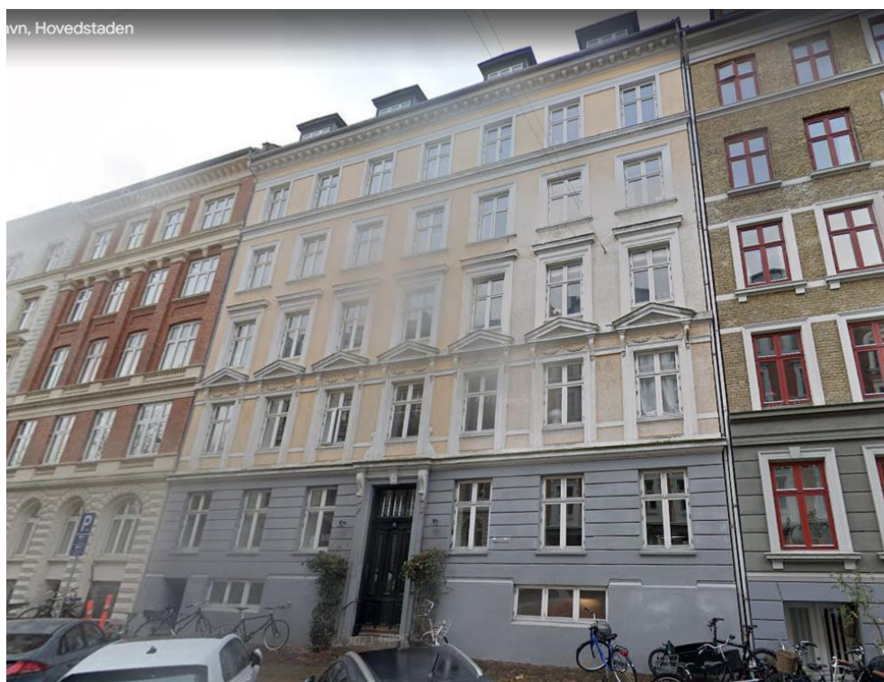
Gadefacaden med vinduer er i rimelig god stand og kræver ikke umiddelbart indsats i de kommende år
