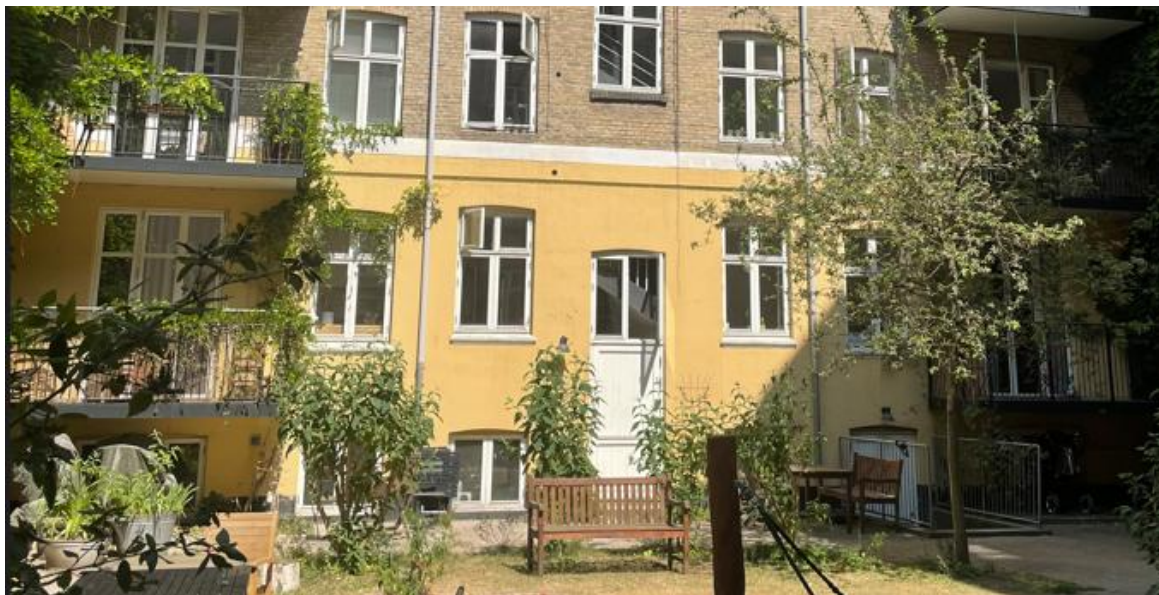
Gårdfacade med puds op til 1 sal er nyistandsat
