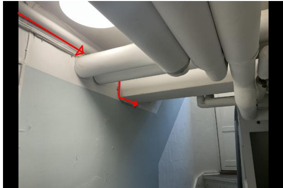
Bemærkninger til billede: Føringsvej til bagtrappens kanaler
