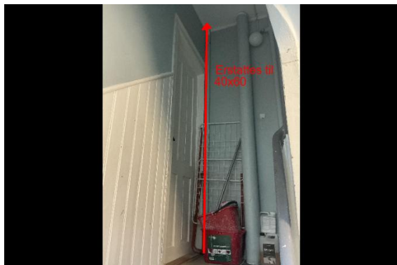
Bemærkninger til billede: De gamle 40x40 kabelbakker erstattes med nye 40x60. St. 1,2,3,4,5 er ens.
