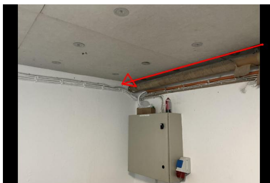
Bemærkninger til billede: Gennemboring til aflåst kælderrum
