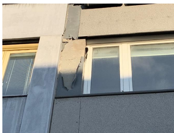
Skade på epoxy-maling mod Mozartsvej.
