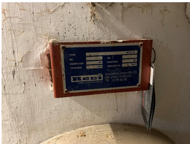
Varmtvandsbeholder er fra 1991.
