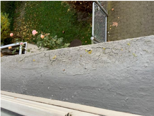
Sålbænke med epoxy revner.
