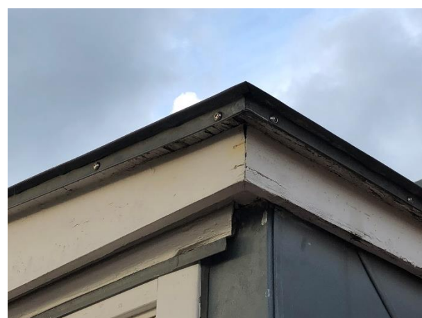
Kviste har nedslidt træbeklædning.
