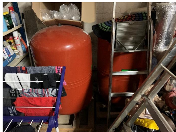
Ekspansionsbeholder i varmecentral.
