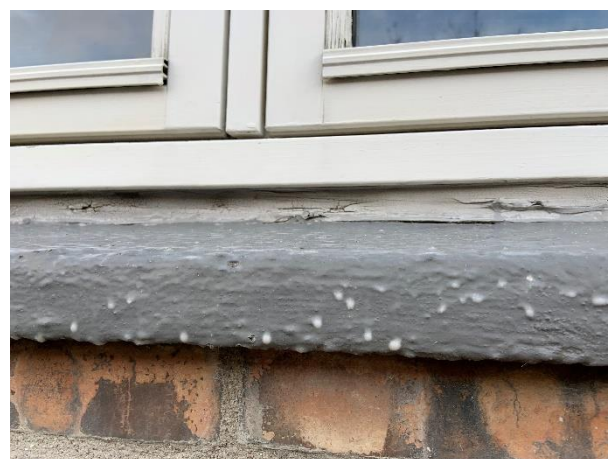
Fuger omkring vinduer udtjente.
