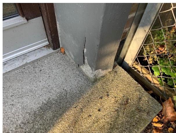
Maling defekte på portaler omkring hoveddøre.
