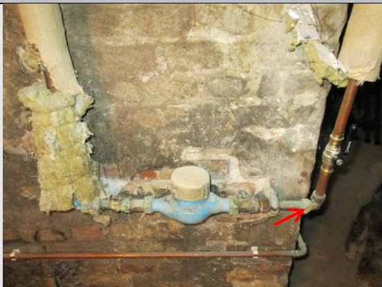
Vandinstallationer i kældere
