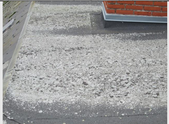
Mos/belægning på tagpap
